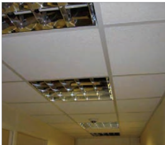
شکل ۱۳۰-۳- نصب اشتباه چراغ‌های مهتابی که سبب خیز برداشتن سقف کاذب مشبک شده است.
