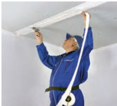
شکل ۳-۸۱- اجرای لایه بتونه در محل درز (کاردک در جهت عمود بر درز کشیده می شود تا بتونه کاملاً در درز نفوذ کند).
